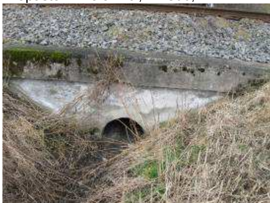
PB inundace u propustku proti toku
